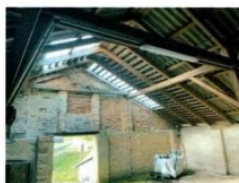
zatékání do krovu
